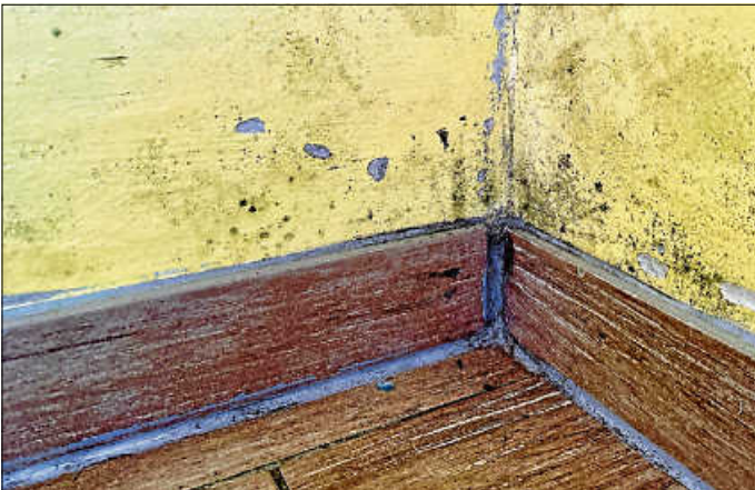
Die Ecken von Räumen sind klassische Wärmebrücken, an denen sich häufig Schimmel bildet. Foto: LEA
