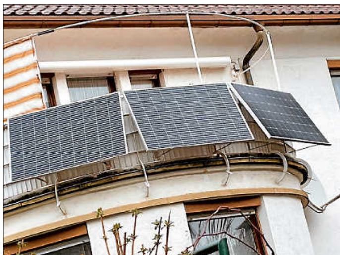
Steckersolargeräte ermöglichen auch Personen in Mietwohnungen eigenen Strom zu produzieren Foto: LEA
