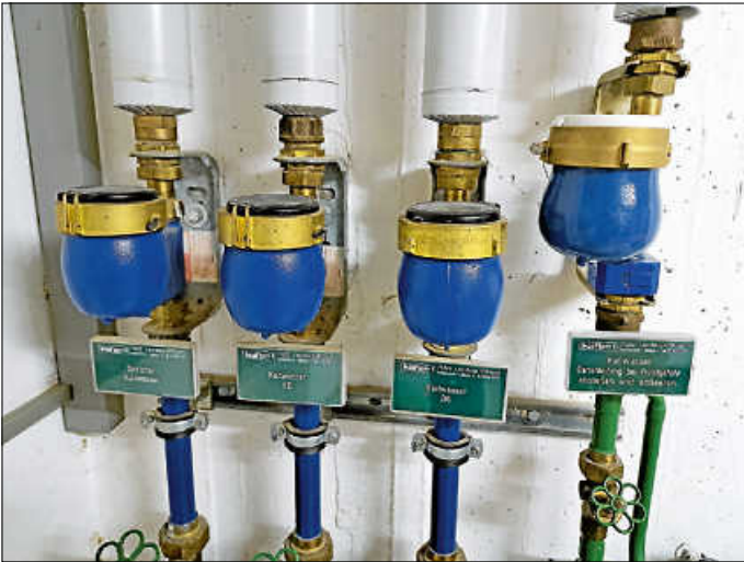
Beispiel für Gartenzählerplatz mit Zählerbügel
